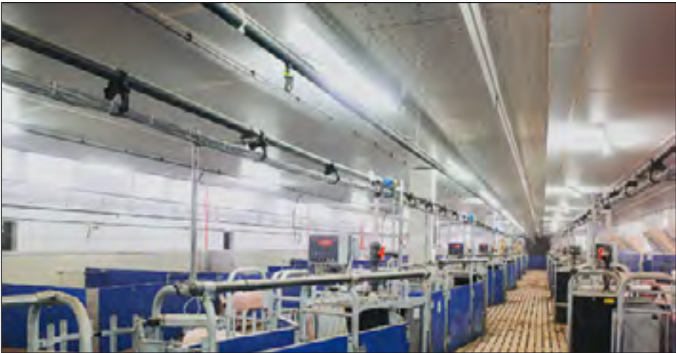
在怀孕区通过喷射降温风道供给新鲜空气
