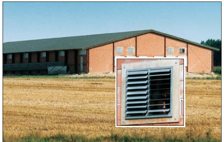
Uso de ventiladores de parede
