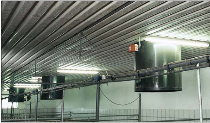
Ventilador axial em pavilhão com tecto diferente
