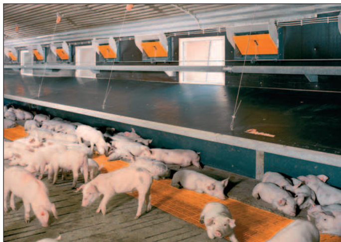
Vykurovací register ako priestorové vykurovanie v oddelení pre odchov odstavčiat
