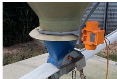
Silos sa električnim vibratorom
