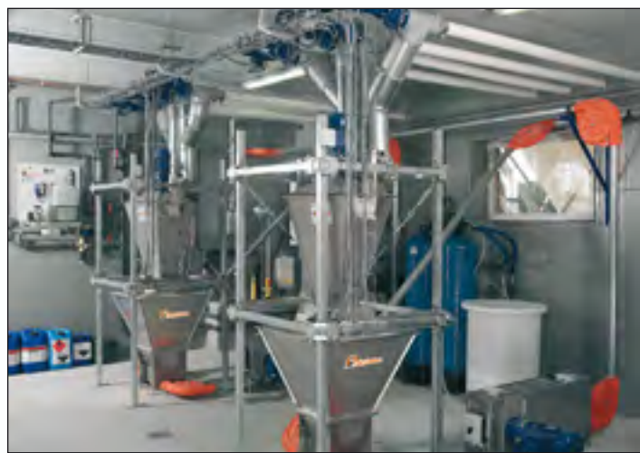
DryExact pro 饲料间：两个系统，每个系统一个饲料回路
