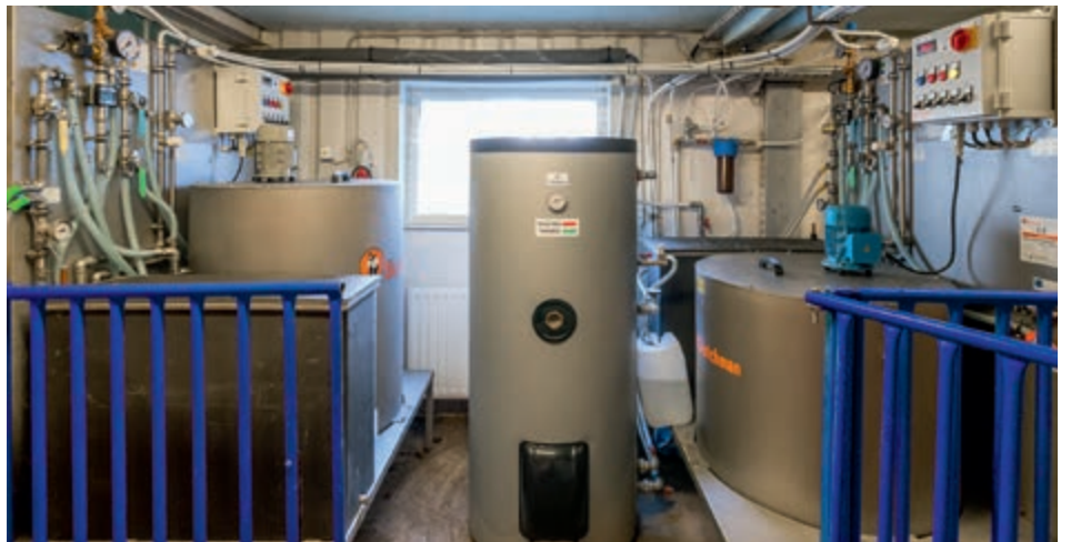
두개의 믹싱탱크가 설치된 큐리나 컵 피드 키친
