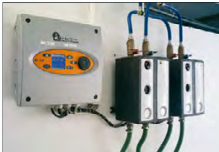
温控电脑 MC 235 控制整个房舍的气候；水暖加热系统的三向控制
